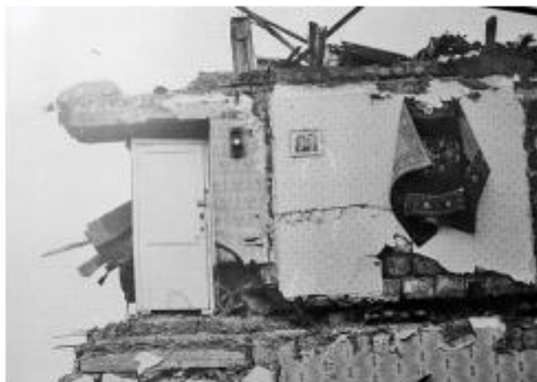
Рис. 8. Последствия Спитакского землетрясения
