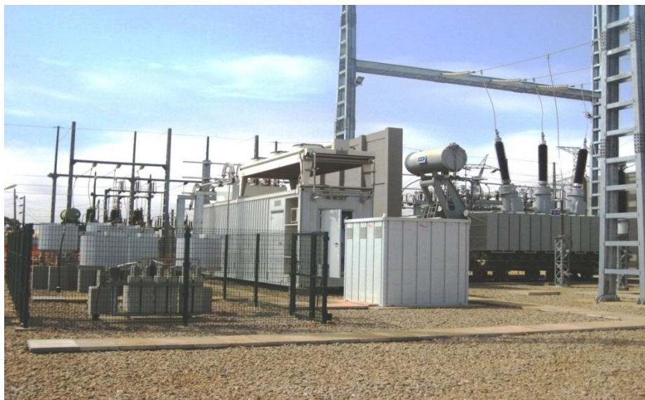
Общий вид УШРТ 220 кВ 60 Мвар на ПС Самата (Ангола)
